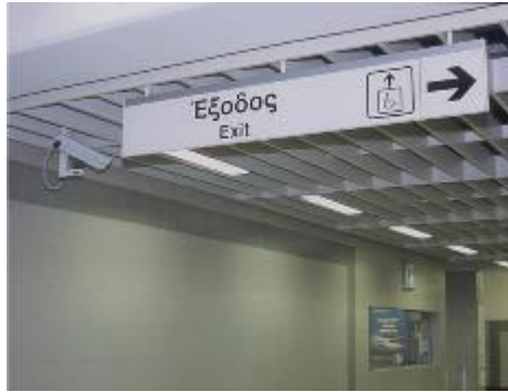
Εικόνα 296 Σήμανση εξόδου / πρόσβασης σε ανελκυστήρα για χρήστες αμαξιδίων σε σταθμούς του μετρό
