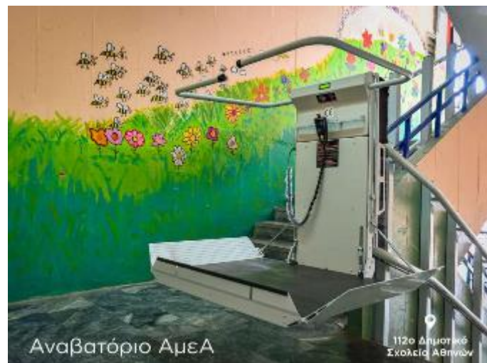
Εικόνα 73. Αναβατήριο κλίμακας με πλατφόρμα σε κλιμακοστάσιο σχολείου
