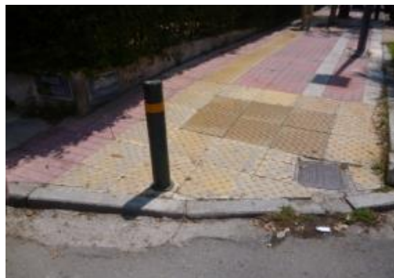
Εικόνα 117 Παρεμπόδιση χρήσης ράμπας λόγω λανθασμένης τοποθέτησης προστατευτικού εμποδίου
