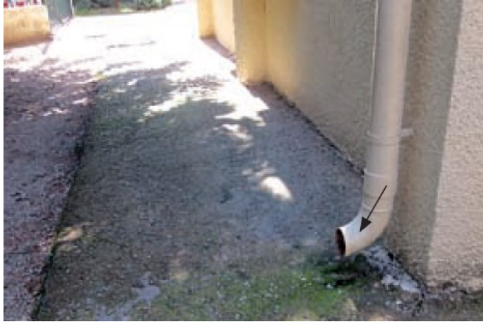
Εικόνα 28. Χαμηλού ύψους προεξοχή της υδρορροής που ενέχει κίνδυνο πτώσης για τους μαθητές που στρίβουν στην γωνία (πηγή: Παπαδόπουλος, Ι. (2015) Περισσότερη ασφάλεια στα σχολεία).
